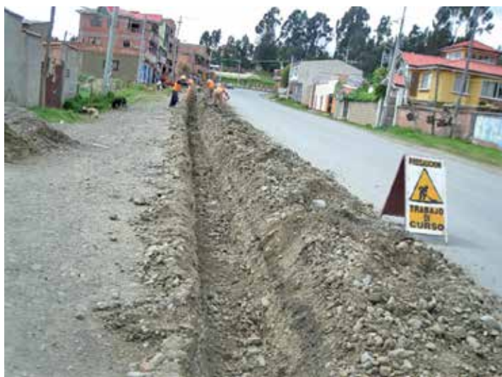
Foto 5: Ejecución de obras de infraestructura del Proyecto de Mejoramiento de Agua de la comunidad Pacajes. (D. Lucano, 13 de junio de 2019).
