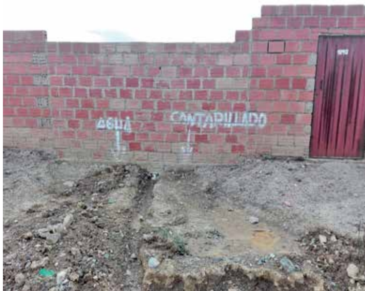
Foto 2: Distrito 7, municipio de El Alto. Instalación de agua y alcantarillado en la Urbanización Nueva Florida. (V.H. Perales, 2018).
