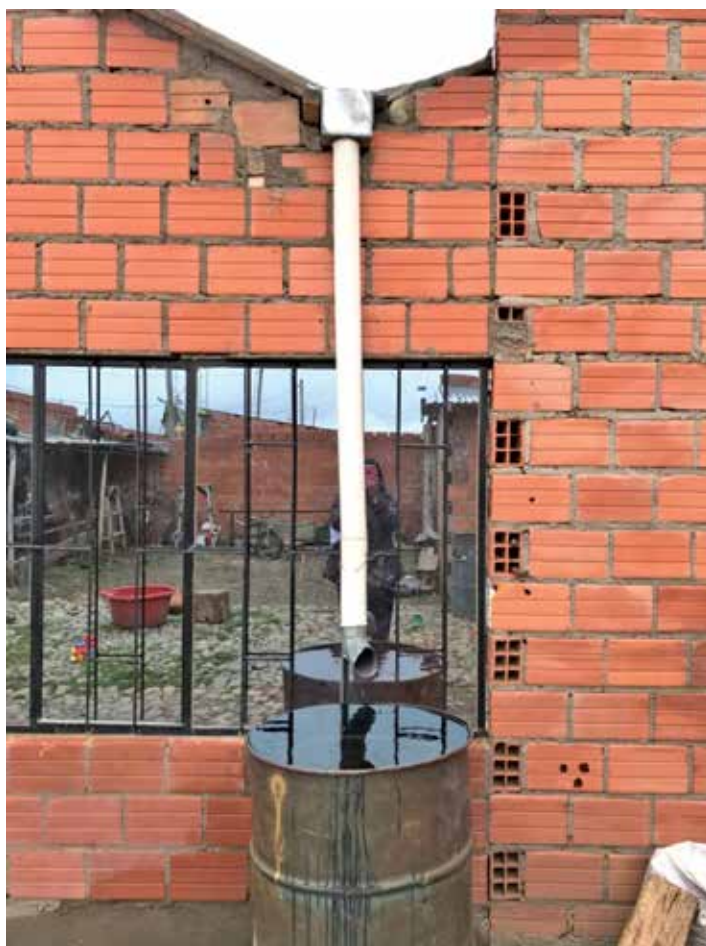
Foto 2: El Alto. Captación de agua pluvial en una vivienda de la urbanización Señor de Mayo I. (Ximena Escobar, diciembre 2018).
